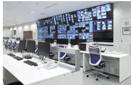
防災センター
