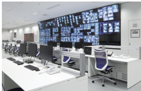
防災センター
