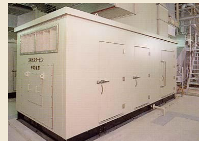
コージェネレーションシステムのガスタービン・発電機
