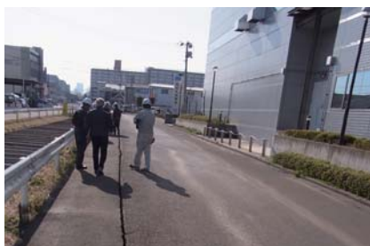
被害状況を確認するエヌ・ティ・ティ都市開発ビルサービス 仙台営業所の担当社員
